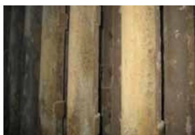
Kessel, beschichtet mit „Spray-and-Fuse“
